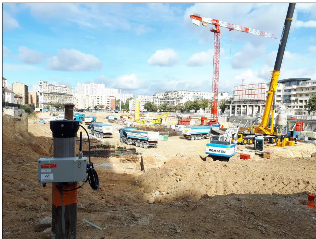
Figure 7 - Exemple de piézomètre avec boîtier d'acquisition autonome radio
