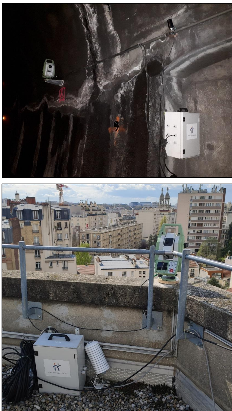
Figure 10 – Stations totales et boîtiers de communication
