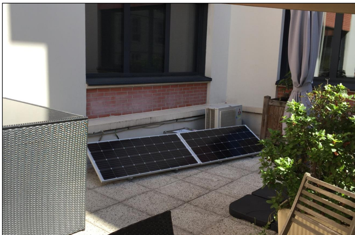
Figure 4 : Exemple d'installation de panneaux solaires
